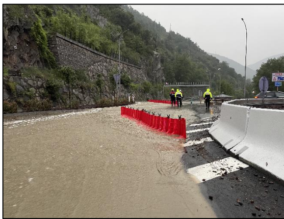
Vista de l'afectació a la CG1
